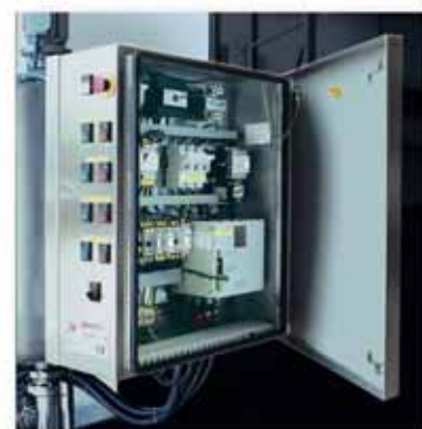
Quadro elettrico Electrical
