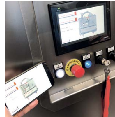
Quadro comando. Control panel.
